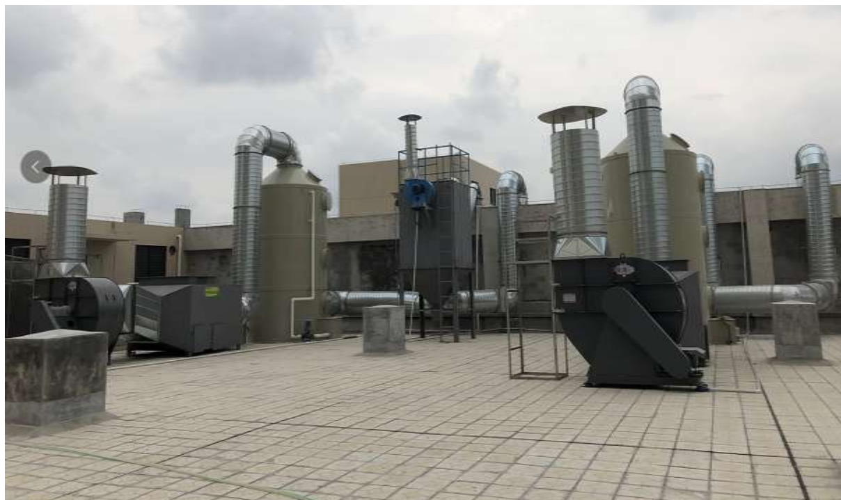
照片 4-10 有机废气排放口 5#—6#、 粉尘废气排放 8#
