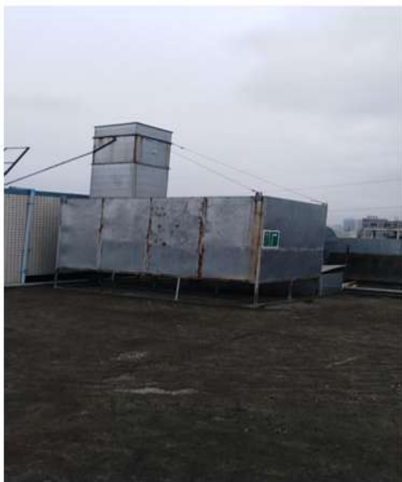
照片 4-6 粉尘废气排放口
