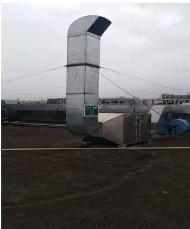
照片 4-8 焊接废气排放口
