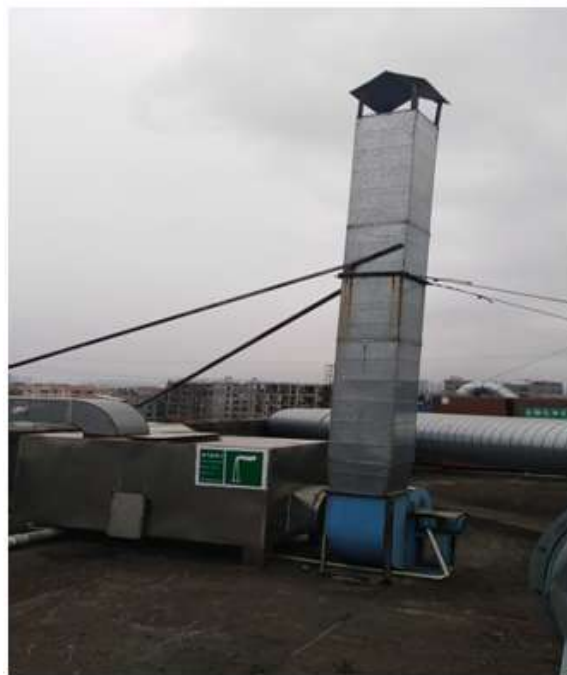
照片 4-7 有机废气排放口
